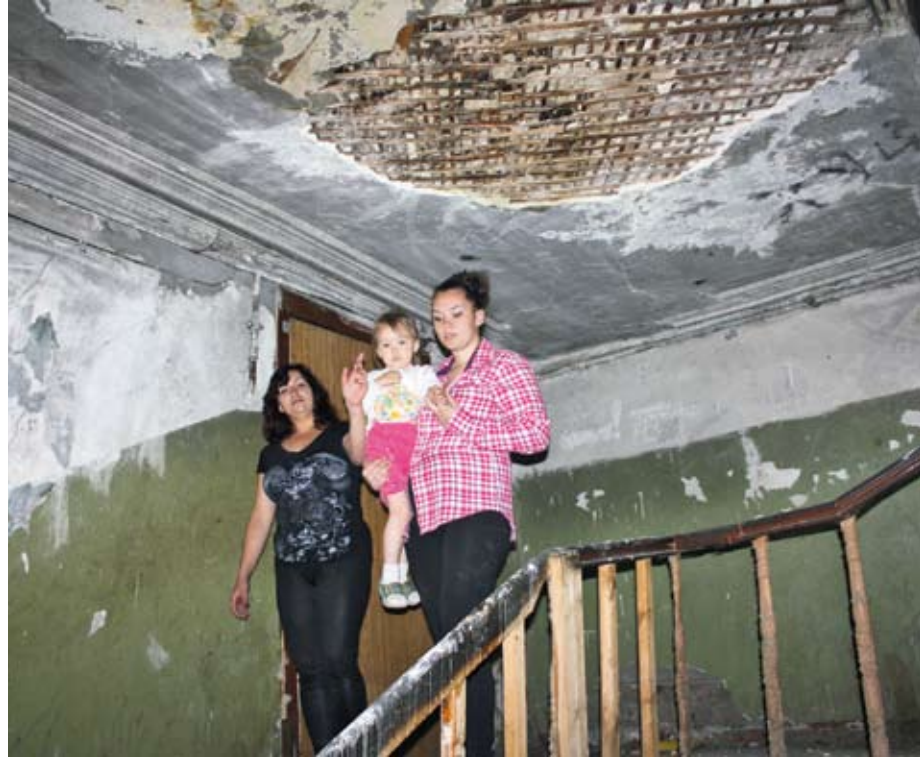
Потолочное перекрытие рухнуло прямо на жителей дома
