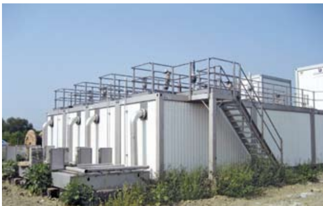
Канализационные очистные сооружения в Аткарске
