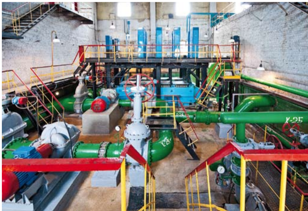
Станция обеззараживания очищенных сточных вод с помощью ультрафиолета
