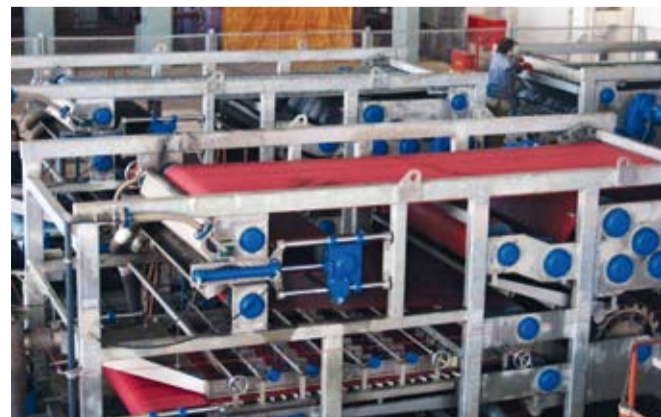
Фильтр-пресса «Петкус» на городских очистных сооружениях Саратова
