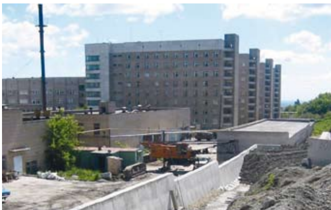
Противопожарные мероприятия по защите областной клинической больницы в Смирновском ущелье
